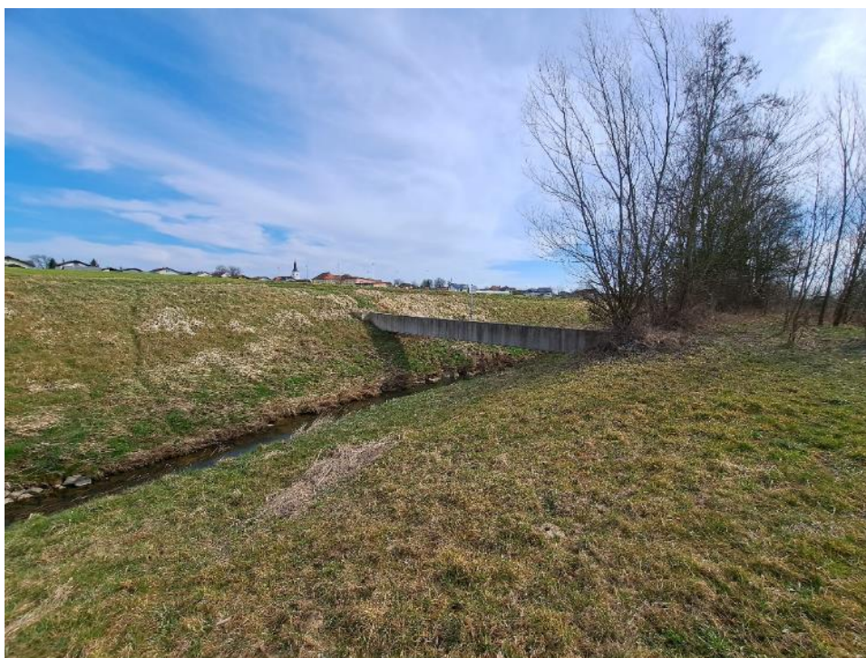
Slika 26: Betonska konzola v strugi Kučnice, ki ob visokih vodah poveča prelivanje v zadrževalnik preko znižanega dela nasipa
