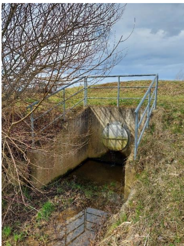
Slika 28: Iztok iz zadrževalnika je zaščiten z nepovratno loputo (t.i. žabjim poklopcem)
