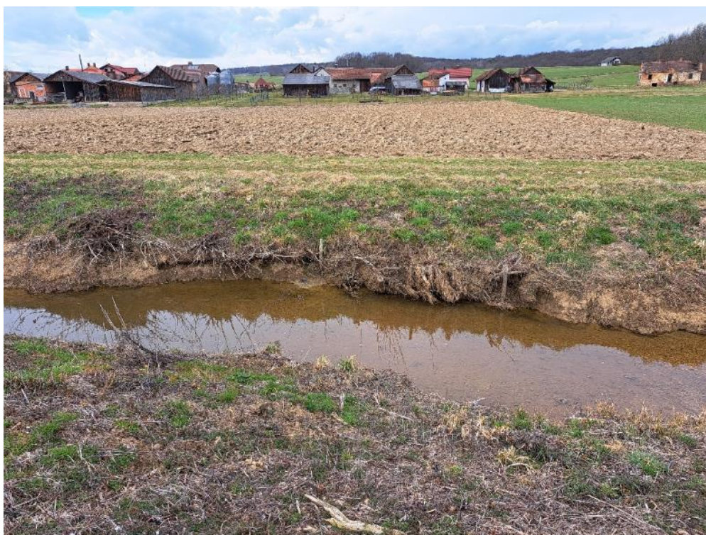
Slika 50: Zavarovanje brežin, ki je začelo odstopati.
