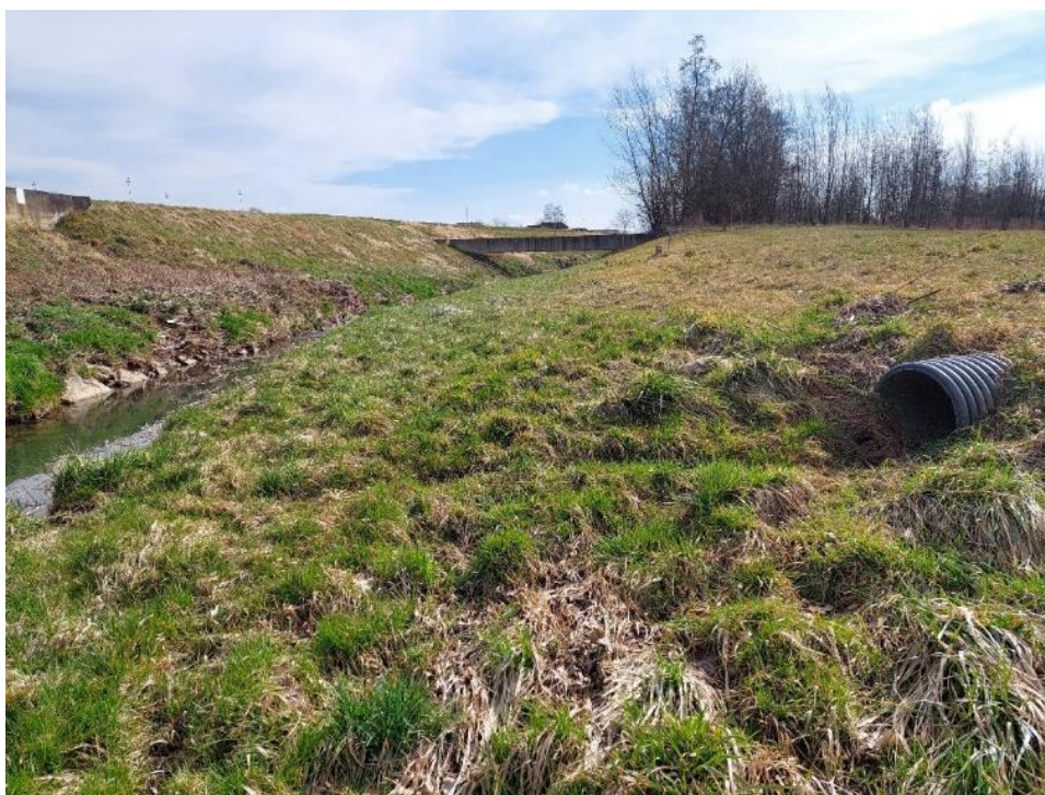
Slika 25: Prepust, ki pri povišanem pretoku prevaja vodo v zadrževalnik
