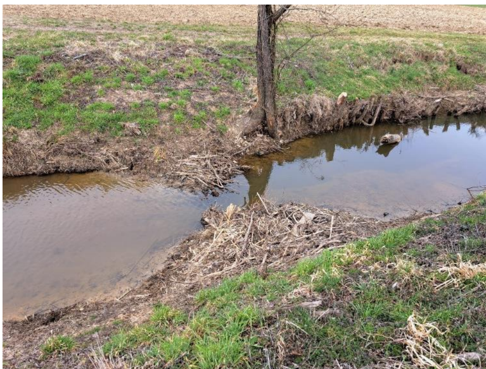
Slika 52: Zožitev nad umetno zajedo. V ozadju na sliki se vidi odstopanje zavarovanja brežine in njeno posledično posedanje
